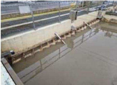
VKB 2 mit neuer Schwimmschlamm-schnecke
