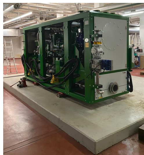
neues BHKW II auf Platz
